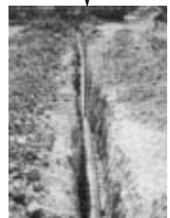
ท่อจ่ายน้ำ
